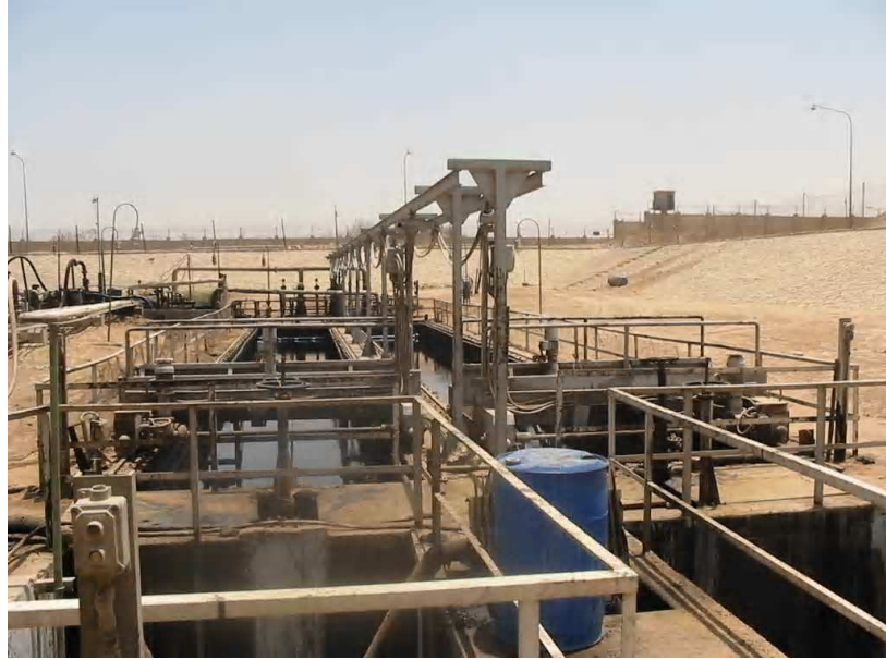
شكل (٤-٦) : وحدة فصل الزيوت المستحلبة بواسطة (DAF) بشركة أسسيوط لتكرير البترول
